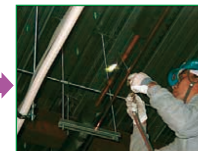
銅管の片方を開放して溶接をします。コストを気にせず、窒素ガスを常時流しながらの作業が可能です。
